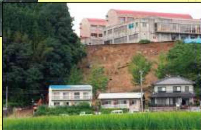
千種中学校法面崩落 (「平成21年台風第9号影響的来雨による災害の記録」 平成24年3月大東市発行から転載)
